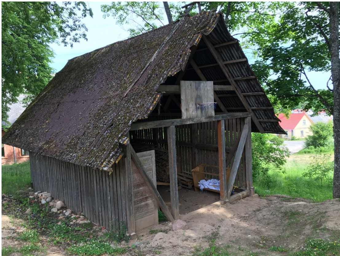
Att. Nr.23 Malkas šķūnīša jumts sliktā tehniskā stāvoklī
