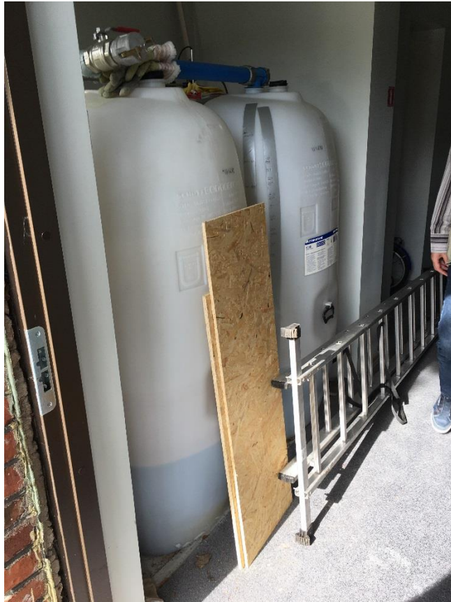
Att. Nr.15 Kurināmā glabāšana – dīzeļdegvielas rezervuāri
