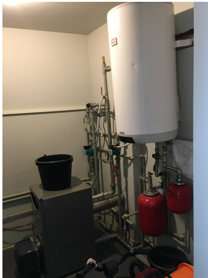
Att. Nr.14 Apkures katls. Boileris.
